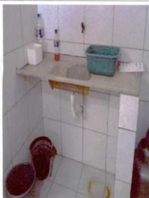
Figura 13: Substituir pia e revisar ponto de esgoto
