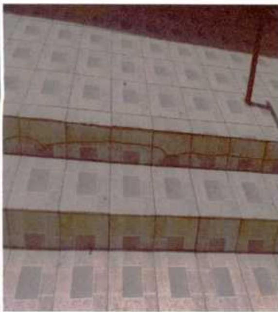
Degraus de Entrada com Avarias
