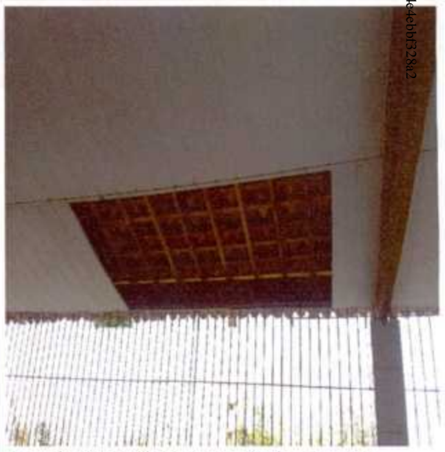
Forro de PVC está necessitando de correção
