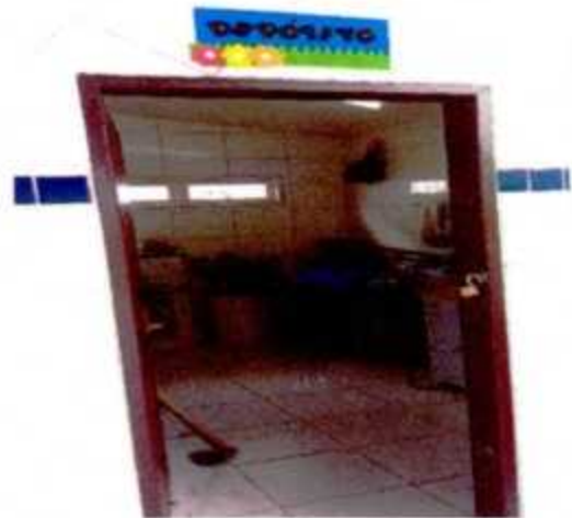
Depósito Porta Precisando de Reparo
