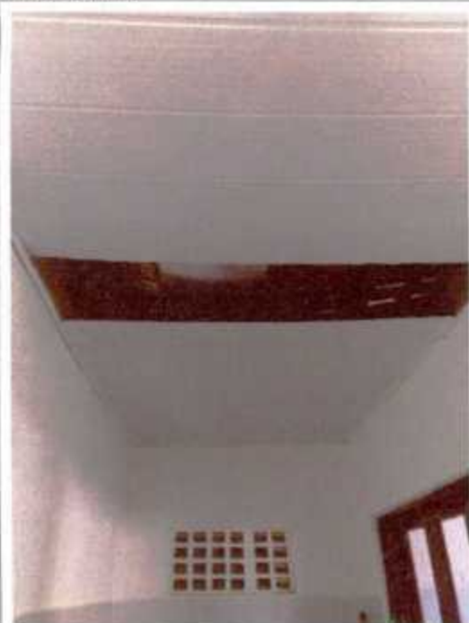
Figura 07: Forro de PVC com Avarias
