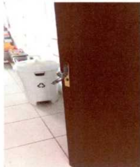
Porta da Biblioteca com a Fechadura Avariada
