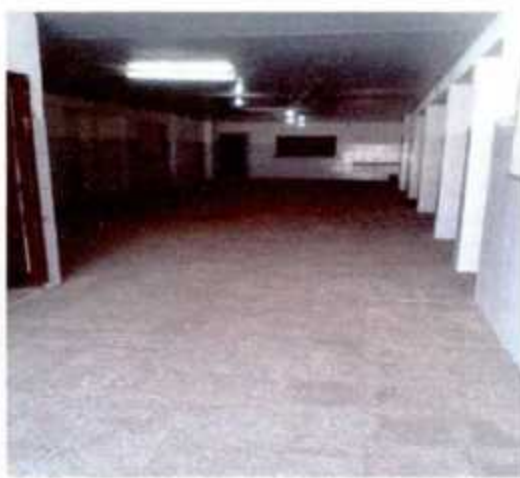
Figura 10: Ausencia da Ceramica do Piso (vista sentido entrada/cozinha)
