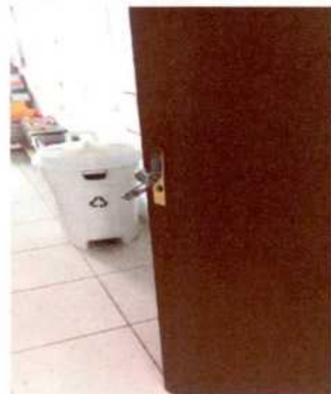
Porta da Biblioteca com a Fechadura Avariada
