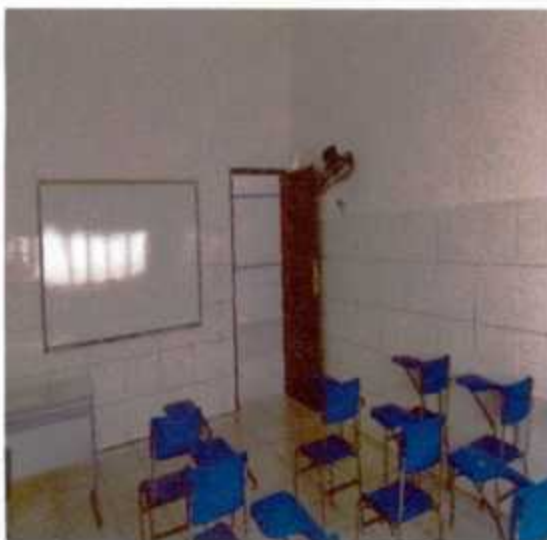
Sala de Aula com Piso e Teto em Bom estado Precisando de Reparos nos Ventiladores, Vidros de Janelas e em Algumas Cadeiras
