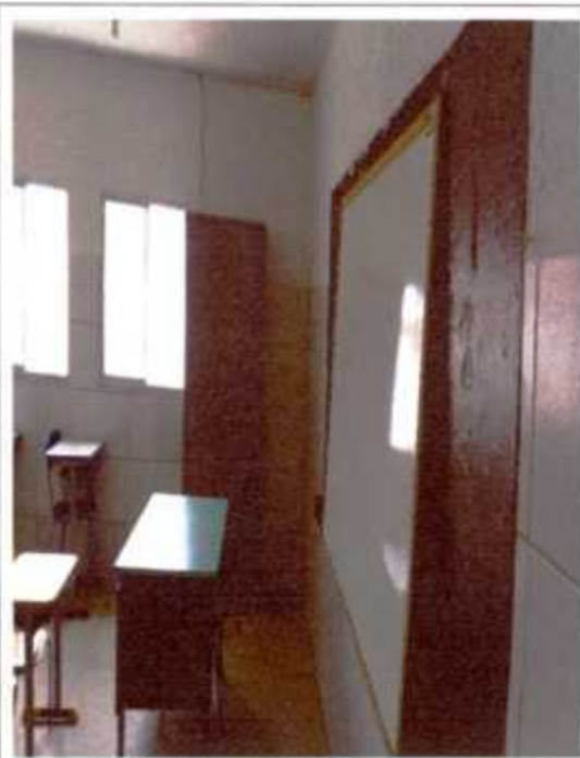
Figura 18: Birôs quebrados ou faltando e faltam quadro branco em 02 salas
