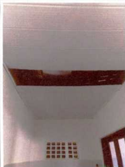
Figura 07: Forro de PVC com Avarias
