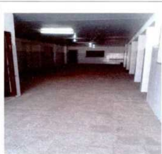
Figura 10: Ausencia da Ceramica do Piso (vista sentido entrada/cozinha)
