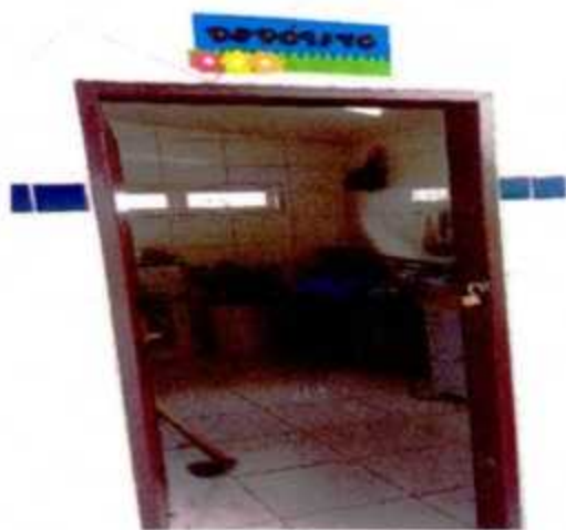
Depósito Porta Precisando de Reparo
