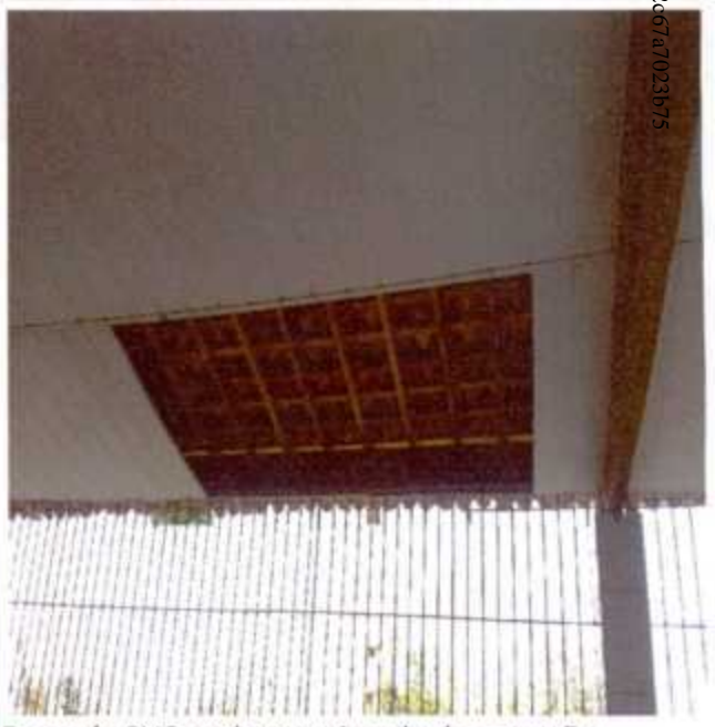
Forro de PVC está necessitando de correção
