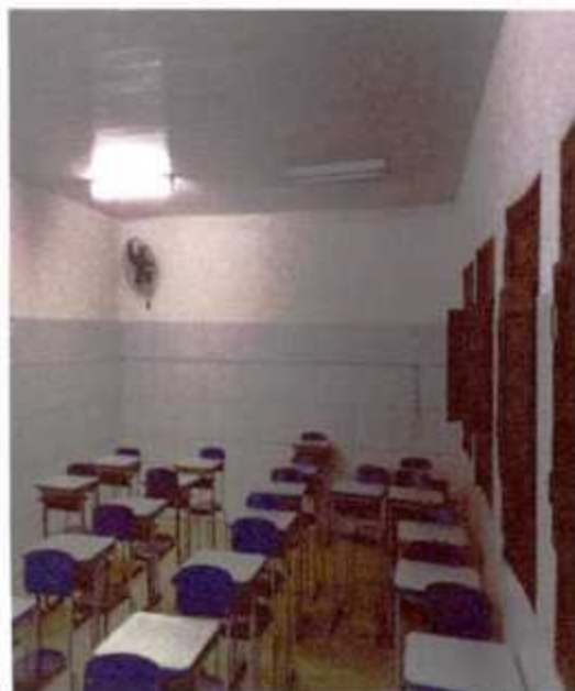
Figura 19: Ventiladores precisam de manutenção e fios estão expostos. Rever iluminação.
