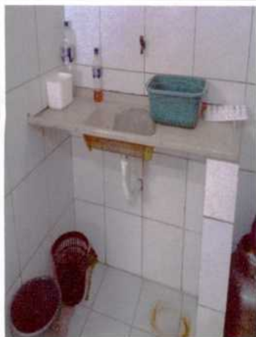
Figura 13: Substituir pia e revisar ponto de esgoto
