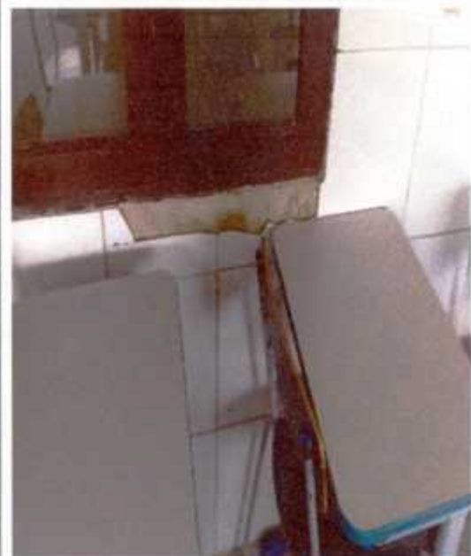
Figura 20: Sala com cerâmica quebrada.
