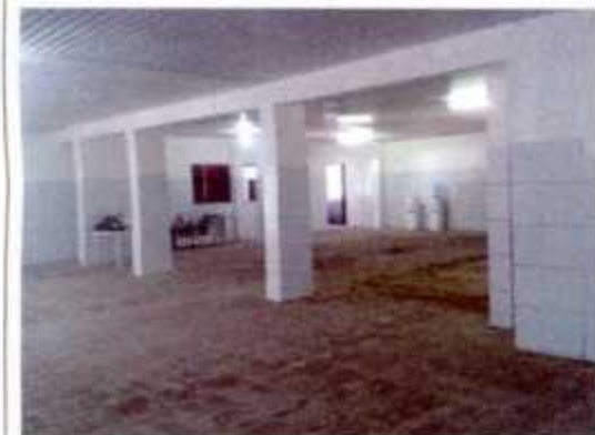
Figura 11: Ausencia da Ceramica do Piso (vista sentido salão para biblioteca)
