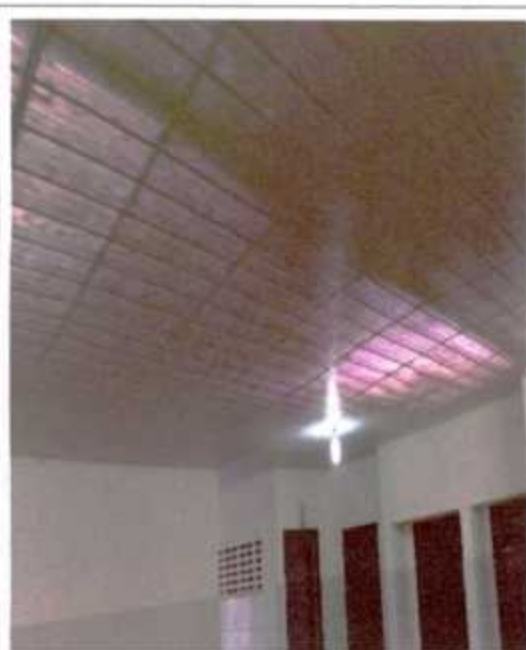
Figura 05: Visão do Forro de PVC (Faltando Telhas Acima)
